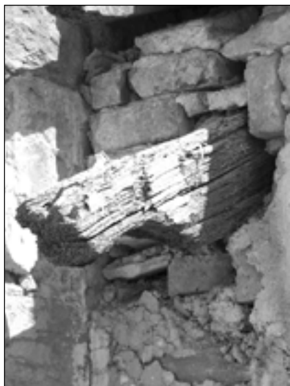
... in ostrešje bo potrebno temeljito obnoviti.
